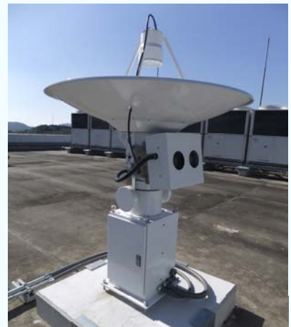
7 号館屋上に設置されているパラボラアンテナ
